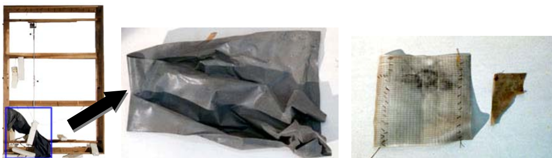
Figure 11 , 12 e 13 . degrado dei diversi tipi di pvac
